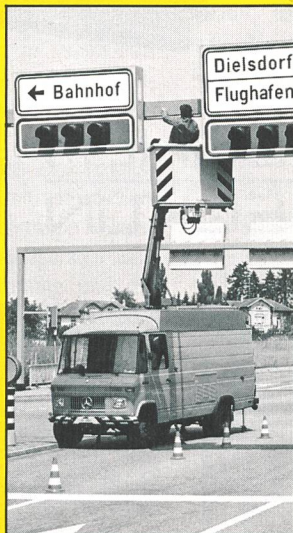
Korrosionsschutz an Signalanlagen
