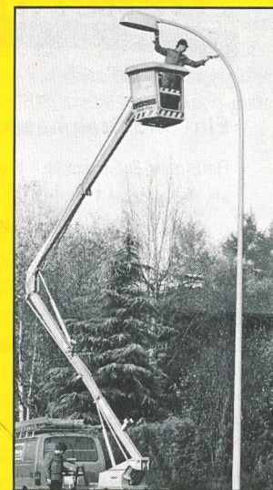
Korrosionsschutz an Stahlkandelabern
