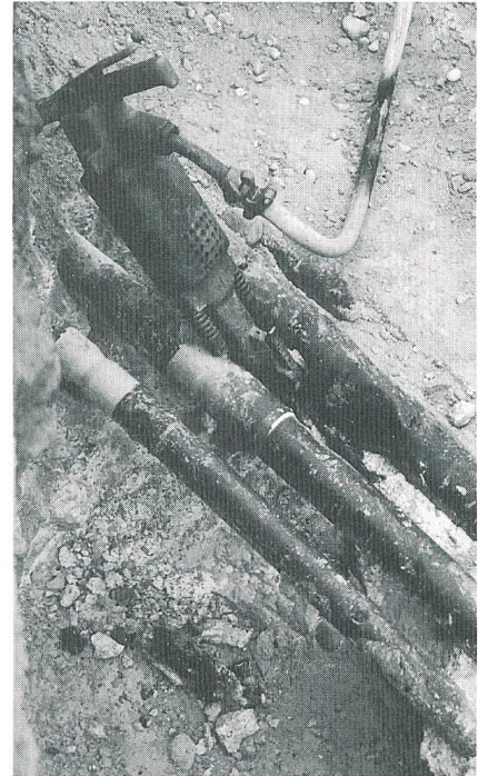
Lieu de l'accident avec le compresseur dans le bloc de béton et dans le câble 10 kV
