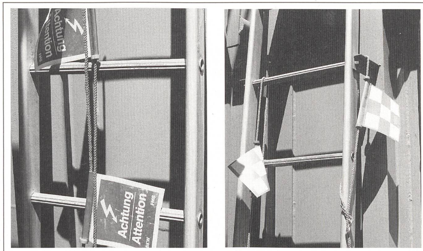
Bild 7 Temporär, während Routinewartung an den Aufstiegen von Grosstransformatoren angebrachte 2-Kriterien-Markierung.
