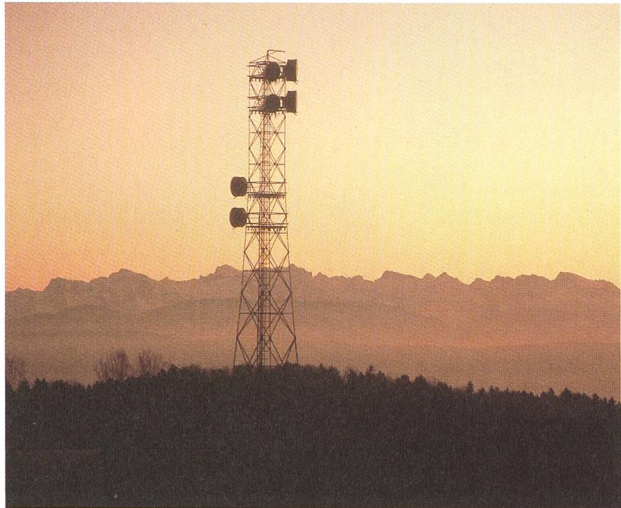
Bild 4 Funk- und Signal-Übermittlungsmast beim Unterwerk Breite (ZH).
