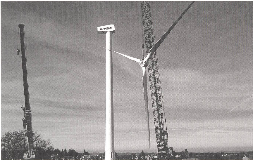
Die erste der drei Windturbinen wird mit Hilfe eines Spezialkrans auf dem Mont-Crosin montiert. Une des trois turbines éoliennes au Mont-Crosin a été montée à l'aide d'une grue automotrice spéciale.
