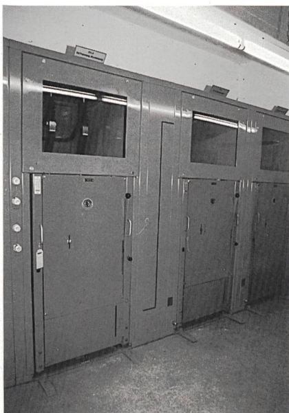
Bild 1 Front TS-Falera/Curnius; nachträglich ein-gebaute Längstrennung
