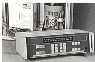
Leistungsmessung mit dem Power Analyser D 5355
