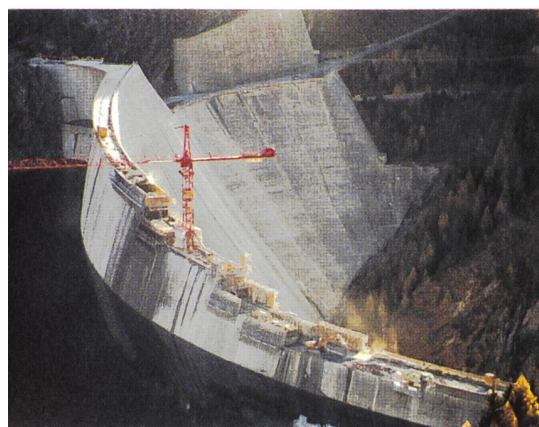
Die Staumauer von Luzzzone (TI) wird gegenwärtig um 17 m erhöht. Damit ist eine Verlagerung von 60 GWh vom Sommer auf den Winter möglich.
