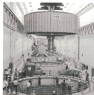
Sieben Generatoren produzieren über eine Milliarde Kilowattstunden jährlich.
