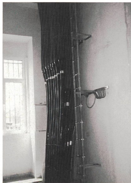
Bild 5 Steigzone im Zentralengebäude in Tirana für 30 000 Teilnehmer (Kupferkabel von Cortailod-Cossonay)
