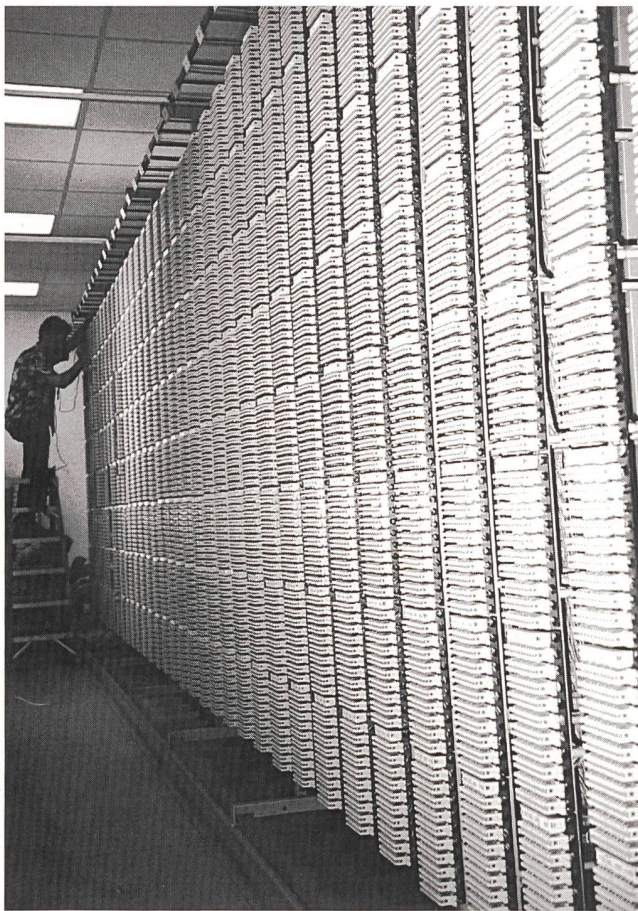
Bild 4 Installation des Hauptverteilers für 30 000 Teilnehmer im Zentralengebäude in Tirana
