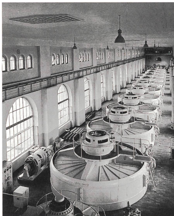
Der Maschinsaal des 1898 gebauten Laufkraftwerkes Beznau.
