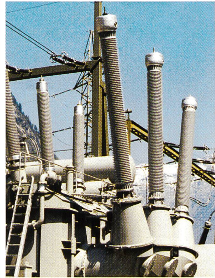
Titelbild: Verbundisolatordurchführungen an 420/220-kV-Leistungstrafo (siehe Artikel S. 19)
