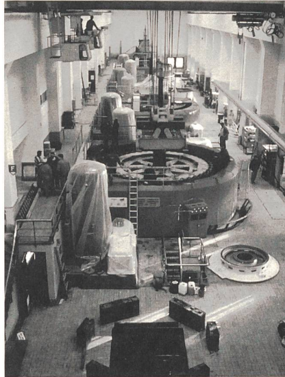
4 La salle des machines au cours du démontage de l'axe d'une turbine (groupe 1). Il s'agit de découpler complètement l'alternateur de la turbine en vue du démontage de chaque élément. L'axe avec son rotor pèse à lui seul quelque 144 tonnes. Le croisillon, l'axe et la jante rotor resteront sur place, où ils seront eux aussi minutieusement nettoyés, analysés et contrôlés. Les corps polaires seront envoyés à Birr, dans les ateliers d'ABB, afin d'y être complètement réhabilités. Il s'agira ensuite de démonter la turbine (c.-à-d. toute la partie immergée) après l'avoir batardée.
