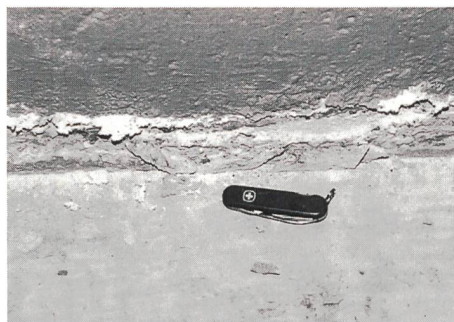
Weisse Salzkruste hinter abgesprengten Betonsplittern (Bild EMPA).
