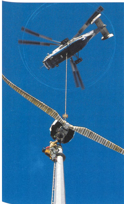
Mit der Installation einer 30-kW-Windkraftanlage auf dem Titlis wurde auch im internationalen Massstab Neuland beschritten. Die Erfahrungen mit dem Bau und Betrieb dieser höchstgelegenen Windturbine in Europa können für die weitere Windenergie-Erschliessung der Alpen und der nordischen Länder genutzt werden (Bild K. Odermatt).
