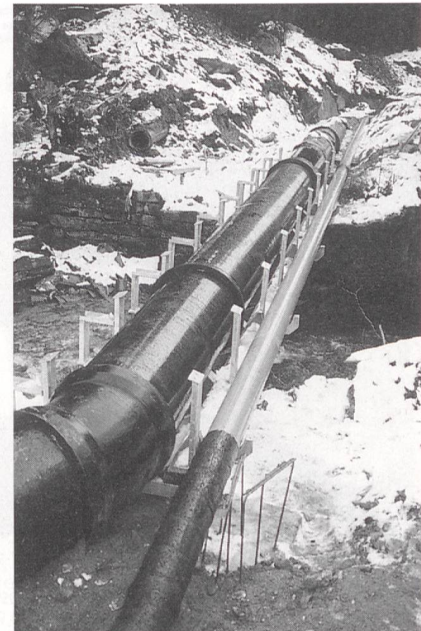
Bild 6 Wie hier bei der ungedeckten Rohrbrücke sichtbar, wurde neben der Kraftwerksdruckleitung noch eine Hochdruckleitung für die Beschneigungsanlage verlegt.
