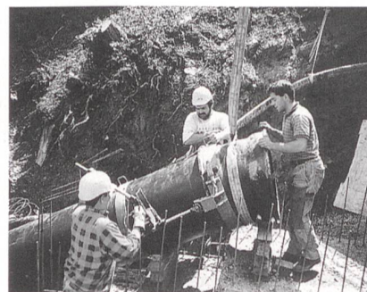
Bild 4 Das einfache Steckmuffensystem erlaubte die Montage der gusseisernen Druckleitung direkt durch den Bauunternehmer.
