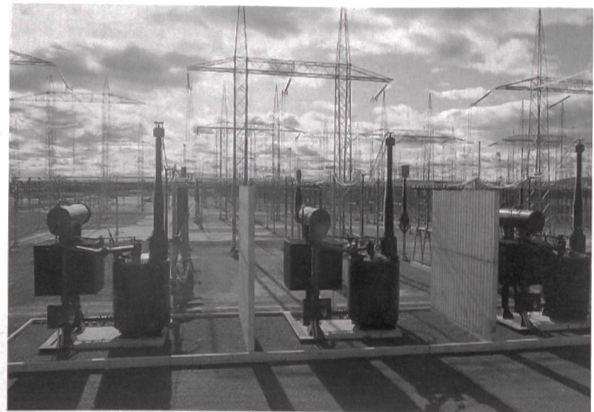
Milliardenschäden auf nördlichen Stromnetzen? (800-kV-Unterwerk in Kanada).
