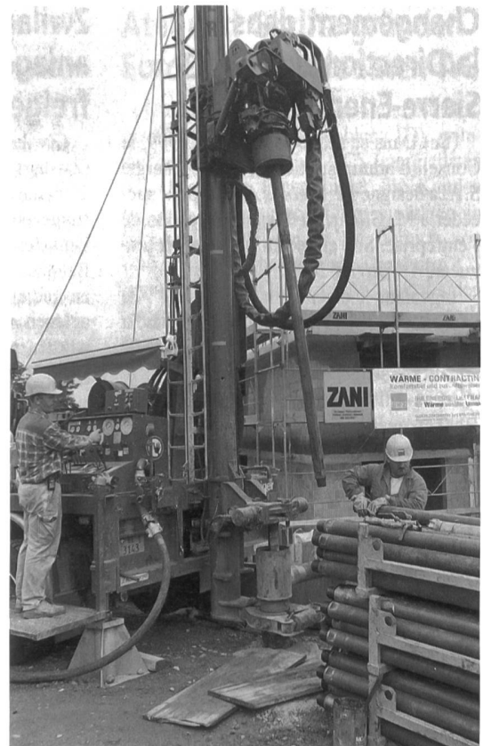
Umweltfreundlich und abgasfrei wird die Winterthurer Überbauung «Weizacker» mit zwei Wärmepumpen geheizt, welche die Wärme über zehn Tiefenbohrungen dem Erdreich entziehen.
