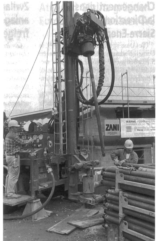
Umweltfreundlich und abgasfrei wird die Winterthurer Überbauung «Weizacker» mit zwei Wärmepumpen geheizt, welche die Wärme über zehn Tiefenbohrungen dem Erdreich entziehen.
