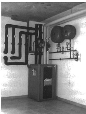
Wärmepumpe in Minergiehaus
