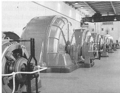
Wasserkraftwerk Küblis: eines der sieben Kraftwerke der AG Bündner Kraftwerke.
