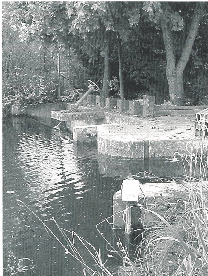
Viele bestehende Kleinwasserkraftwerke erzeugen den Strom ökologisch (Bild: Nova Energie).
