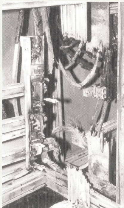
Brand durch Erdschluss in einer Elektrohauptverteilung. Auf den Boden tropfende verflüssigte Aluminium- und Kupferteile entzündeten anschliessend auch den Barackenboden. - Incendie provoqué par un court-circuit dans un distributeur principal. L'aluminium et le cuivre liquides s'égouttant sur le sol ont ensuite mis le feu également au sol de la baraque.
