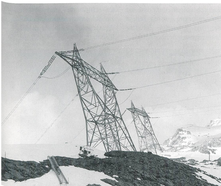
Die Schweiz stellt mit ihren alpenquerenden Hochspannungsleitungen das wichtigste Transitland.
