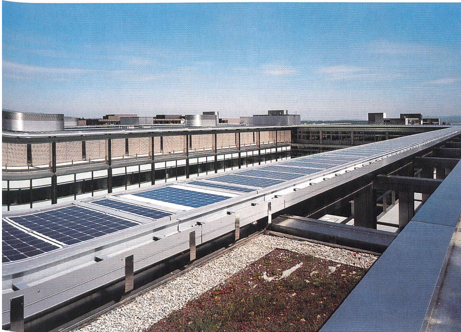
Bild 1 Die PV-Anlage ist sorgfältig in die Dachlandschaft integriert.
