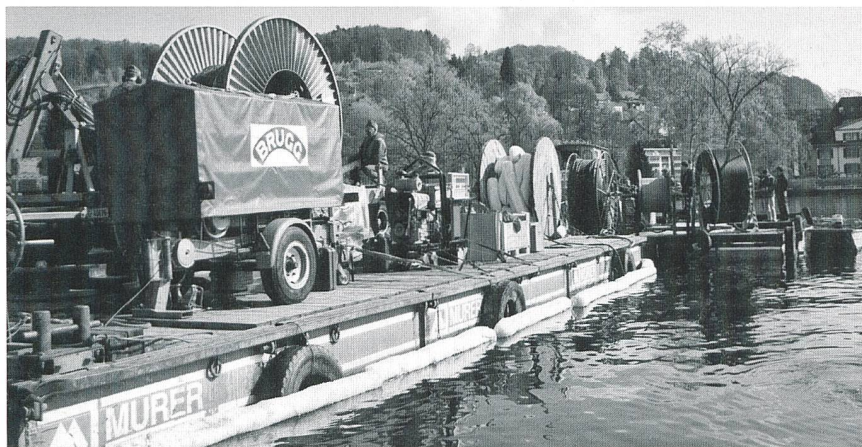
Die Kabelrolle auf dem Ponton zog das 50-kV-Kabel ein, während hinten bereits wieder neue Kabel ins Seebecken verlegt wurden.
