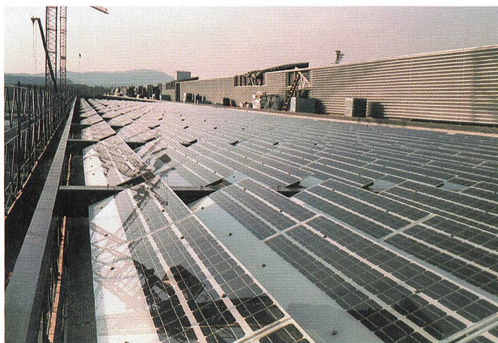
Bild 4 Solarzellenfeld auf der Südseite des Gebäudes.
