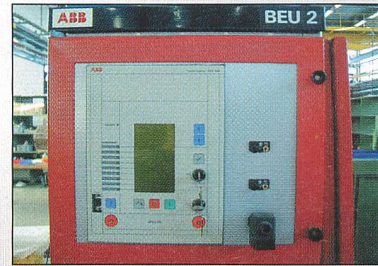
Engineering von Schaltanlagen
