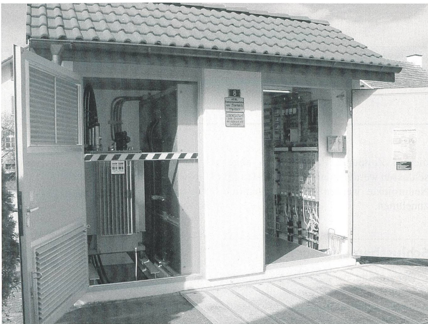
Transformatorstation eines Regionalnetzbetreibers.
