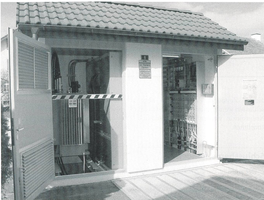
Transformatorstation eines Regionalnetzbetreibers.
