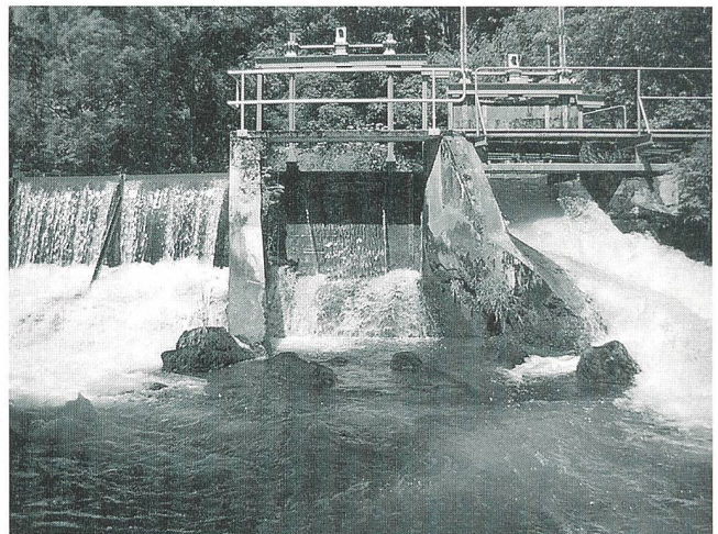
Staufstufe beim Kleinwasserkraftwerk «Dubuis» im Berner Jura.
