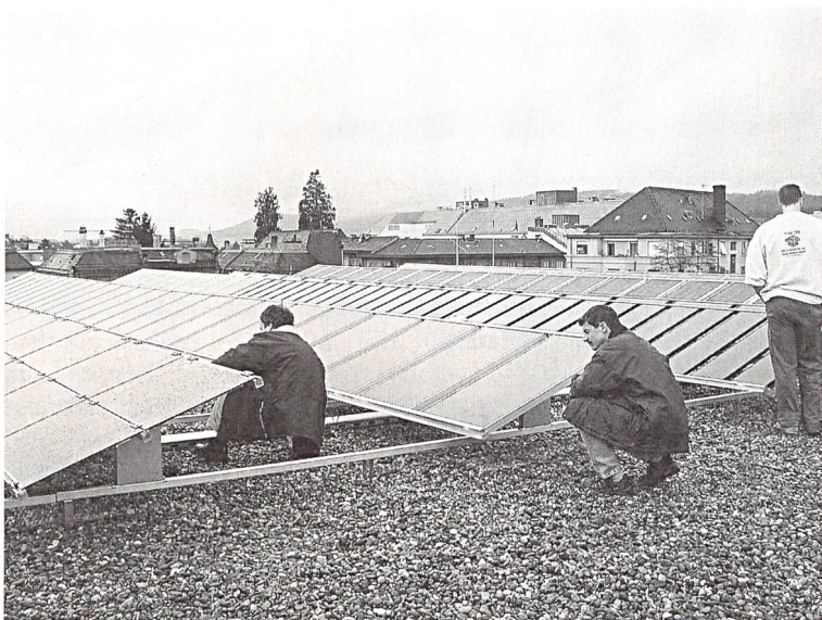
Die Versuchsanlage auf dem Dach der Migros in Altstetten trifft auf breites Interesse Bild: vse/wü).
