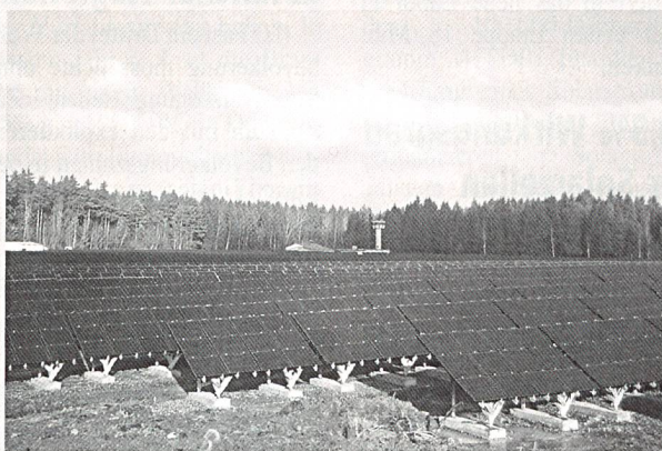
Weltgrösster Solarpark (4 MW) in Hernau (D).
