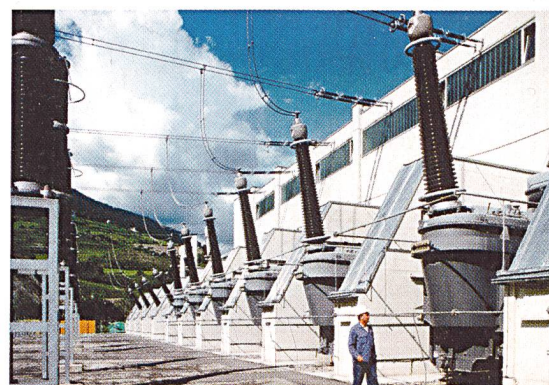
Titelbild: Transformatoranlage bei der Zentrale in Riddes (VS).
