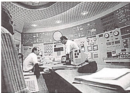
Kontrollraum im KKW Kosloduj.
