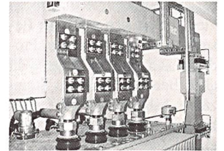
Trafoanschluss mit Lanz-HE-Übertragungsstromschienen
