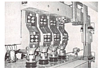
Trafoanschluss mit Lanz-HE-Übertragungsstromschienen
