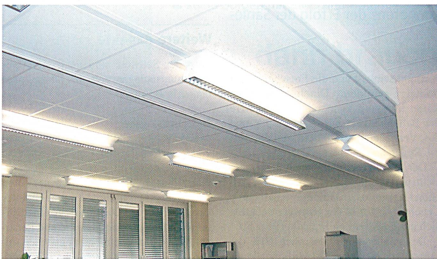
Bild 3 Alte, ineffiziente Beleuchtungsanlage in Bürogebäude vor der Sanierung, unten die neue Anlage.
