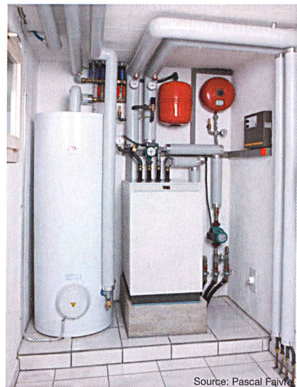
Figure 5 Propre et peu encombrante: une pompe à chaleur datant de 1995
