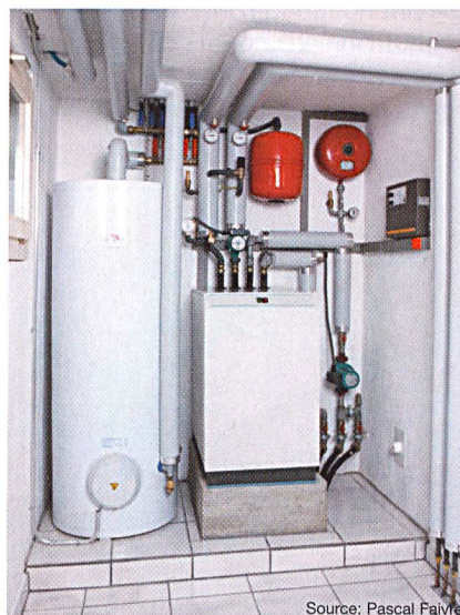
Figure 5 Propre et peu encombrante: une pompe à chaleur datant de 1995
