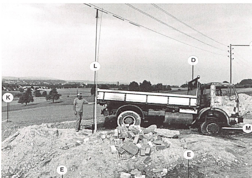
Zu kleiner Abstand zwischen Trassee und Freileitung, fehlende Kontrolle, unvorsichtige Arbeitsweise Distance insuffisante entre la chaussée et la ligne aérienne, absence de contrôle, manière imprudente de travailler
