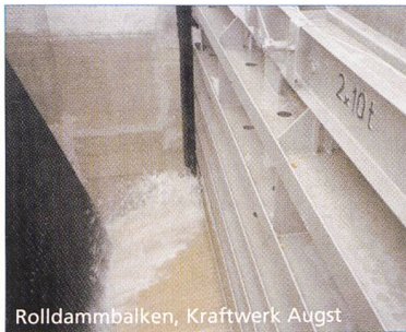
Rolldammbalken, Kraftwerk Augst
