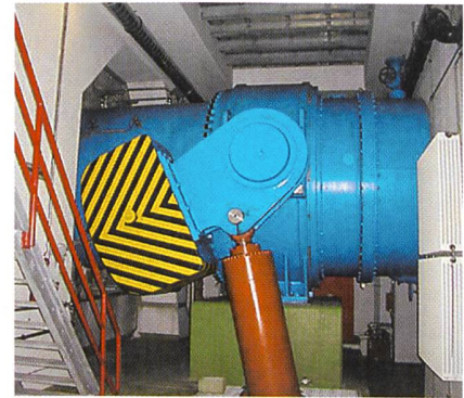
Drosselklappe (Absperrorgan) in der Zentrale Martina (Bild: ewk).
