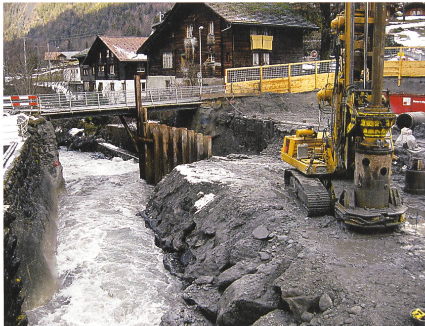
Baugrube «Wehröffnung links»: Vorbohren im grobblockigen Flussgrund für das Einvibrieren der Spundbohlen.
