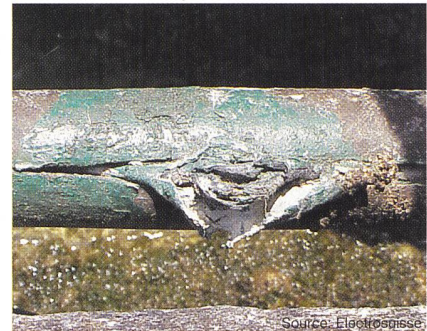
Figure 8 Vue de détail du tube métallique
