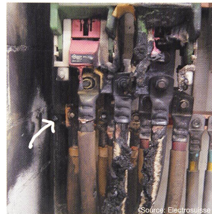
Fig. 6 Vue du lieu de l'accident
