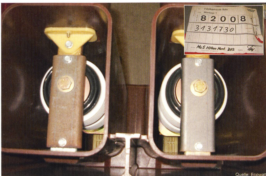
Bild 1 Korrodierte Vakuum-Schalter Im linken Pol blieb ein Fertigungspapier liegen. Über zehn Jahre hinweg korrodierte der Schalterpol.
