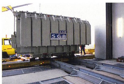
Vom Tieflieder ins Unterwerk.
