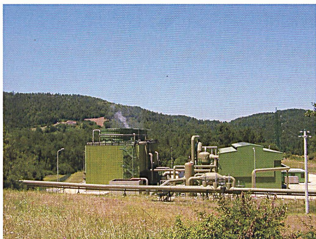
Anlage Travale im Gebiet Larderello.
