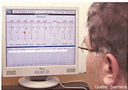
Bild 2 Bedienplatz Die Anlagenübersicht erlaubt einen komfortablen Betrieb
