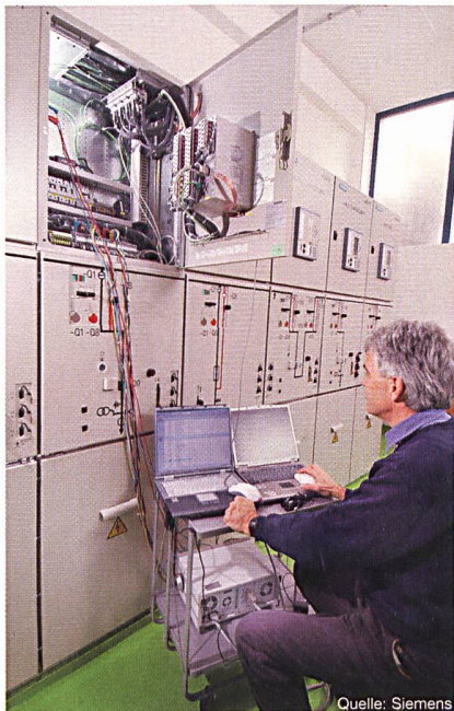
Bild 1 Unterwerk Winznau Schachen nach IEC61850
