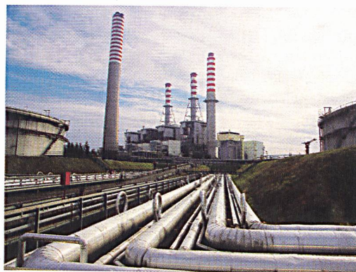
Das thermische Kraftwerk Sermide in der Nähe von Mantova wurde in den letzten Jahren in ein modernes Gas-Kombi-Kraftwerk umgebaut (Bilder: atel).
