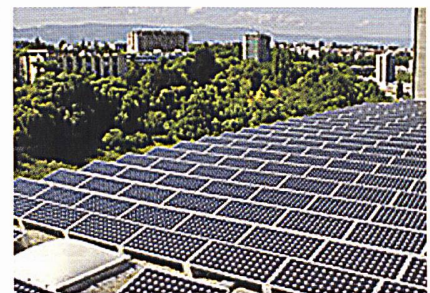
Effiziente Solarzellen in Genf (Bild: suntechnics).
