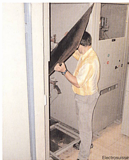
Bild 8 Die Einschubplatte ist zu breit und kann nicht eingeführt werden ... und wo ist die persönliche Schutzausrüstung? (nachgestelltes Bild)
