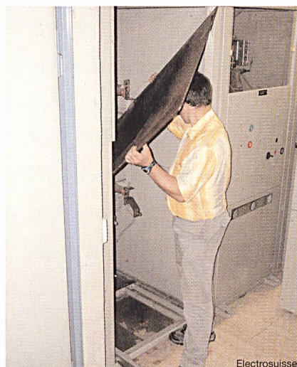
Bild 8 Die Einschubplatte ist zu breit und kann nicht eingeführt werden ... und wo ist die persönliche Schutzausrüstung? (nachgestelltes Bild)
