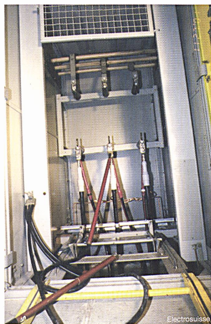
Bild 11 Schaltzelle mit Erdungsgarnitur mit feststehendem Erdanschluss
