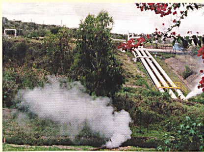
Dampfleitungen beim Kraftwerk Ol Karia im Rift-Valley (Kenia).
