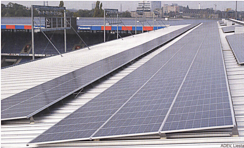
Bild 5 Erst spät haben die IWB die Solarenergie für die Wärme- und Stromproduktion entdeckt. Die Anlage auf dem Fussballstadion St. Jakob-Park war wegweisend für Anlagen wie das neue Fussballstadion in Bern.
